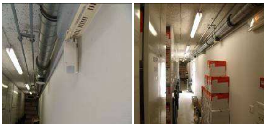
Exemple de local des archives en zone restreinte disposant d'une alarme volumétrique anti-intrusion.
